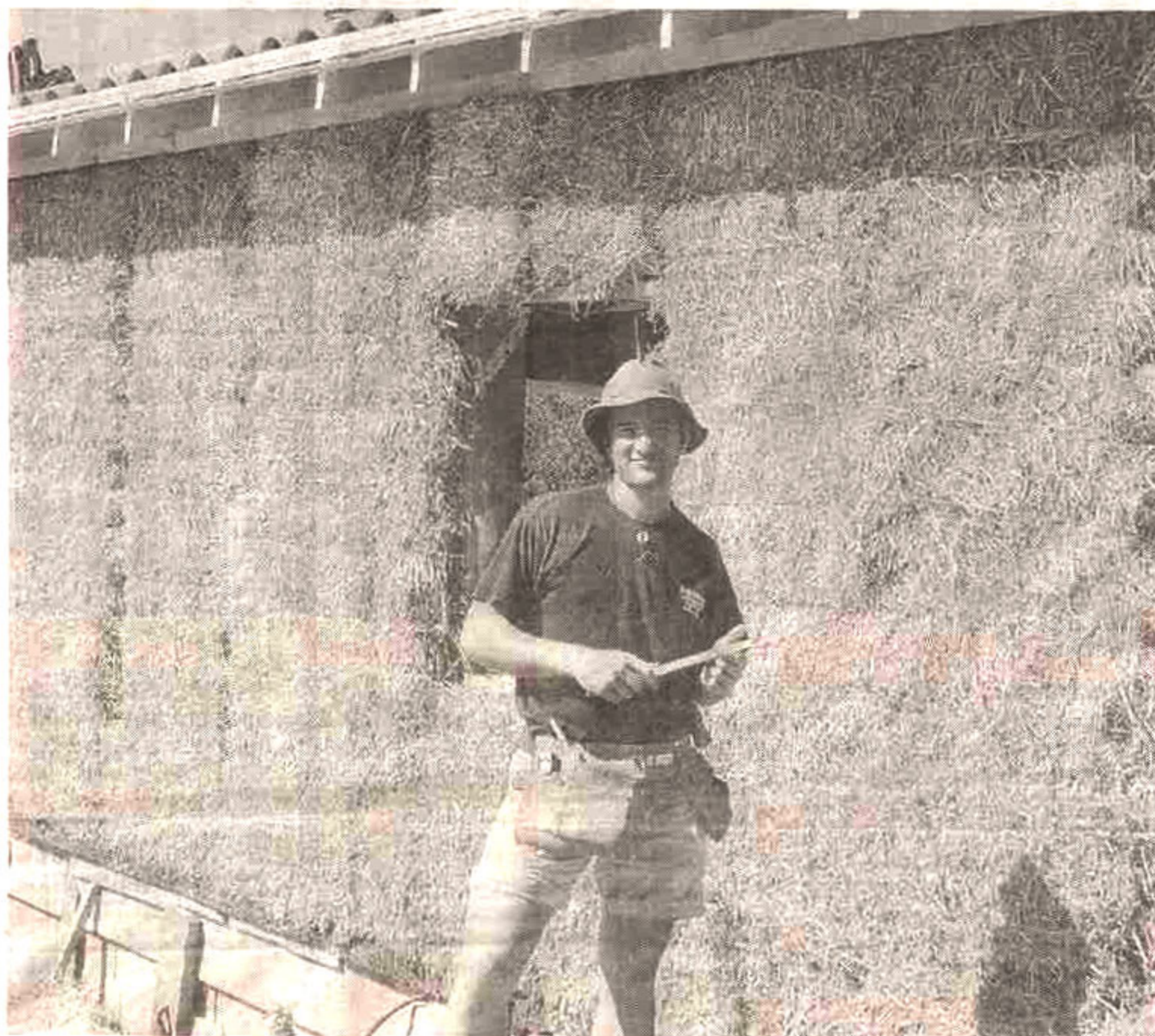
Mathieu Junique de Bâti Nature devant une maison en construction à Batherney (près de St-Donat dans la Drôme).
